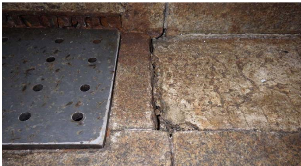
確認された鼠穴（割れ目）
