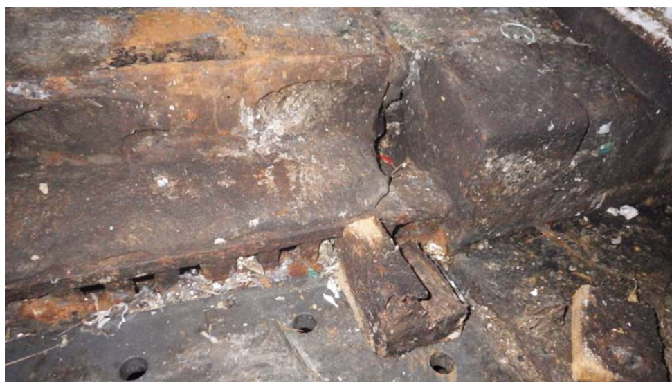
確認された鼠穴（劣化コンクリート）
